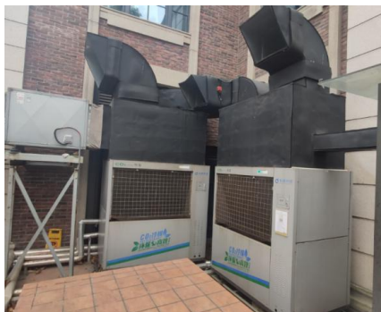
图 5.36 CO 2 热泵热水节能改造实景
